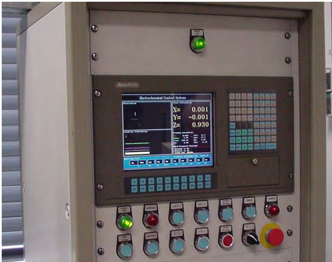
Рис. 6. Общий вид управляющей панели стойки управления.
